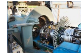
Contrôle d'intégrité des conduites
