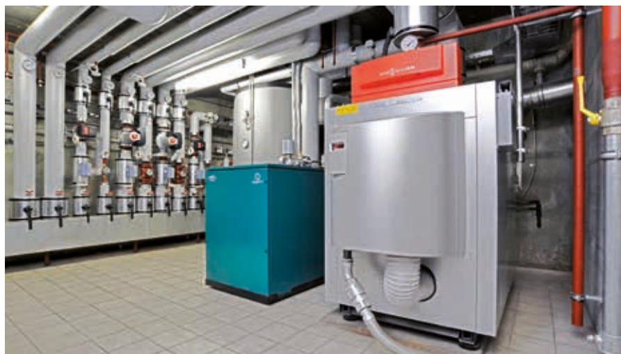
Abbildung 5: Das Micro-BHKW (links) lässt sich problemlos in die Haustechnikzentrale integrieren. Praktisch der gesamte WKK-Strom wird im Haus genutzt («Eigenverbrauch») – eine attraktive Kombination von Ökologie und Wirtschaftlichkeit.
