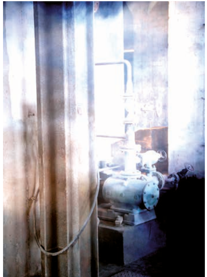
Abbildung 3: Die Wärme-Kraft-Kopplung ist eine bewährte Technologie, wie dieses Foto einer historischen Haustechnikzentrale zeigt.
