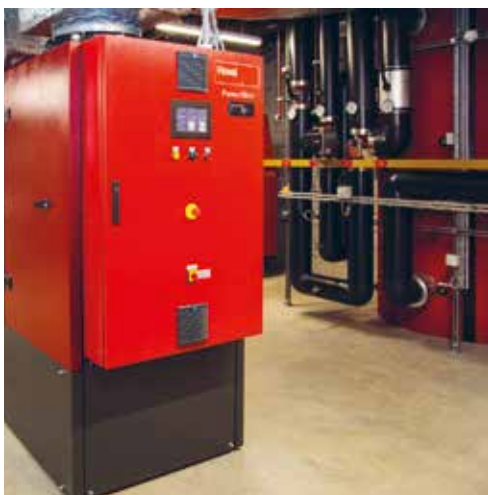
La centrale de cogénération, le cœur de l'installation de la SWG (à g.) et l'accumulateur de chaleur (à dr.). Photo Hoval
