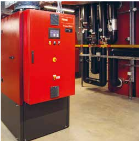
Das Blockheizkraftwerk, das Herz der SWG-Heizzentrale (links), und der Wärmespeicher (rechts). Bild: Hoval
