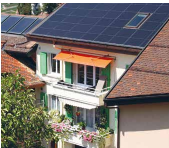
La casa plurifamiliare a Yverne. A destra, nella parte di tetto con la finestra, l'impianto fotovoltaico; a sinistra, l'impianto solare termico con una superficie di 9 m 2 .
