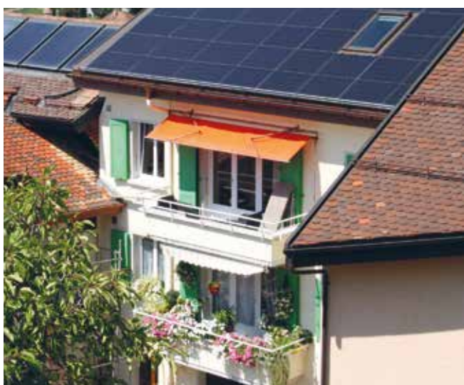
L'immeuble locatif d'Yvorne. A droite, avec la fenêtre de toit horizontale, l'installation photovoltaïque; à gauche, l'installation solaire thermique d'une surface de 9 m 2 .
