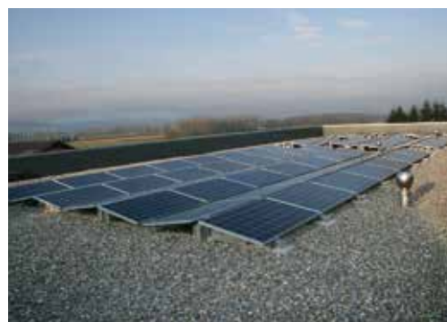
Die 190 m 2 grosse Photovoltaik-Anlage.
