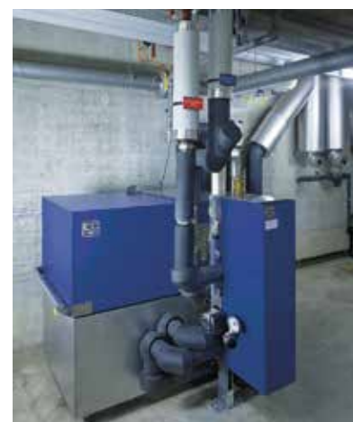
La mini-PCCE EC Power et, devant, son séparateur hydraulique.
