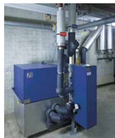
Das Mini-BHKW EC Power, vorn seine hydraulische Weiche.
